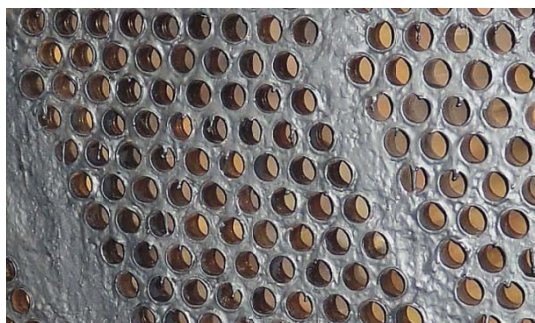
Рис. 1. Состояние трубок конденсатора турбоагрегата Т-100-130 после очистки и обработки
